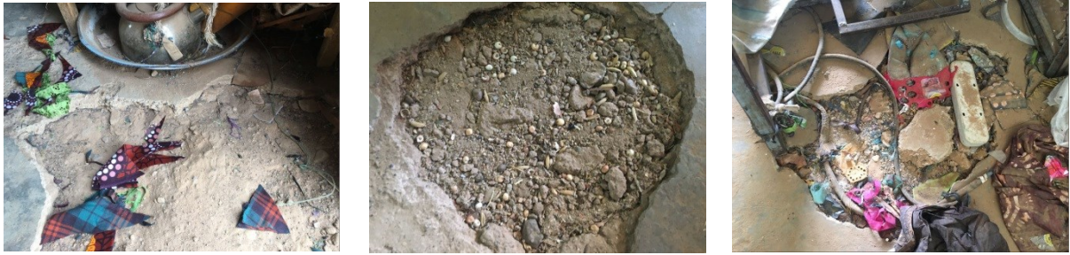
Figure 8 : exemples des anfractuosités constatées dans des boutiques, ateliers, cuisines, magasins, chambres, etc.
